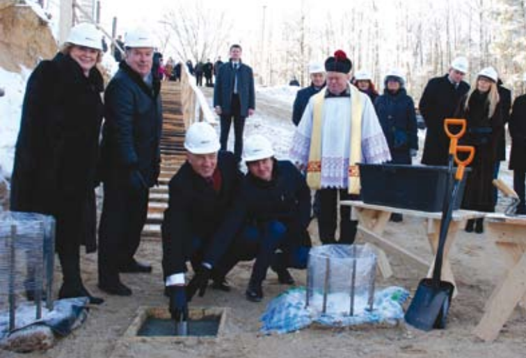
Daugiafunkcio sporto centro statybos pradžia. „Prie išskirtinių projektų priskirčiau šio centro statybą, kurių tikimės užbaigti greičiau nei per ketverius metus. Birštone sukurta visa reikalinga infrastruktūra, tačiau žiemos sezonui labai trūksta uždarytų sporto salių. Pastačius naują sporto kompleksą atsiras krepšinio, futbolo, tinklinio, lauko teniso ir kitos aikštės“, – sakė merė N. Dirginčienė (kairėje)
